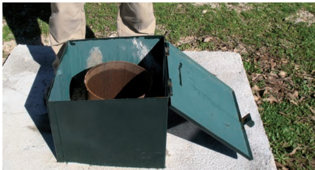
Piezómetro para control del nivel de agua subterránea. Los Llanos del Campo
