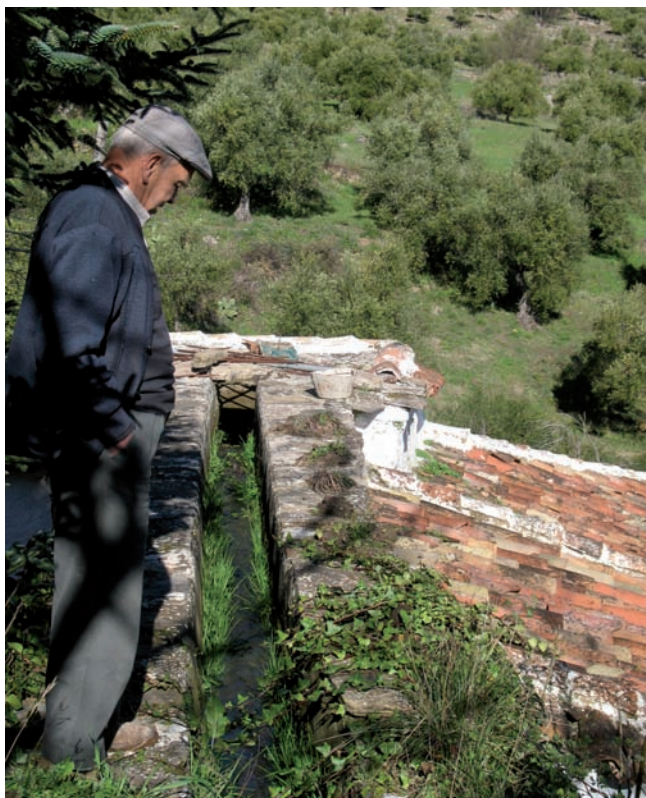
Atajea en que finaliza la acequia, antes de su caída al cubo para accionar el rodezno. Molino del Rincón, Ribera del Gaidóvar
